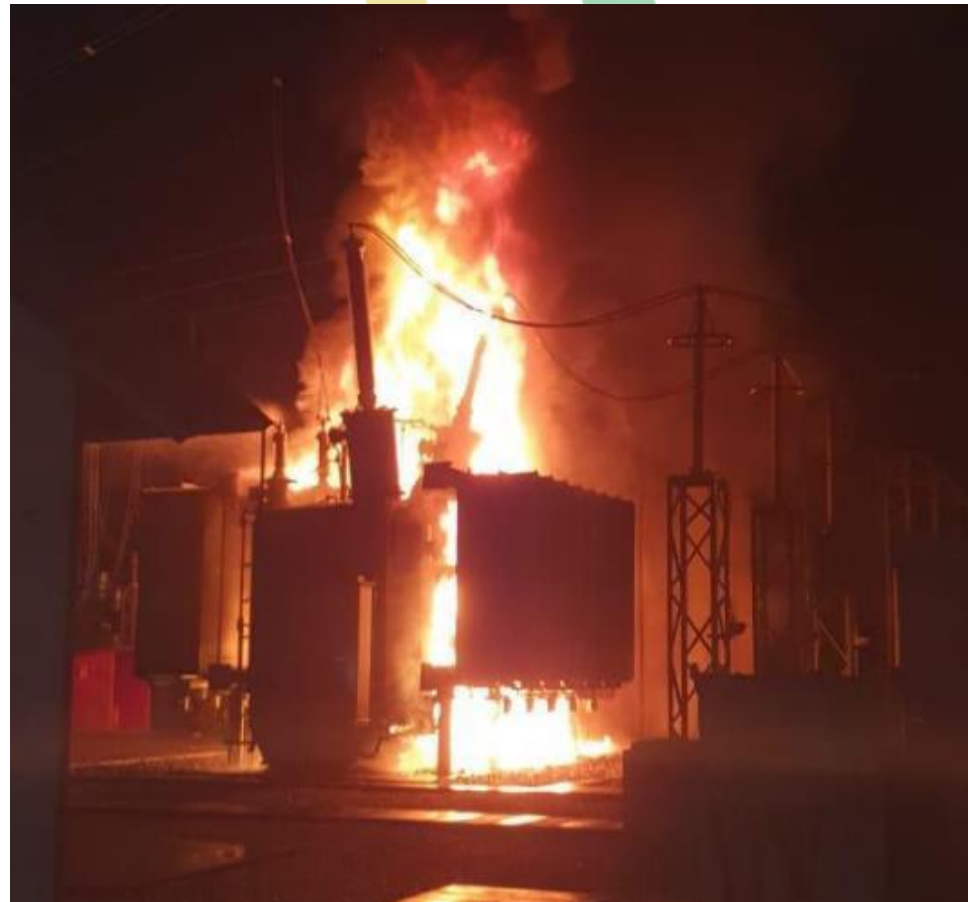
Incêndio no Transformador TR1 da Subestação Macapá (03/11/2020)
